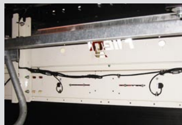
2002 Elektrik ohne Verteilerkasten
